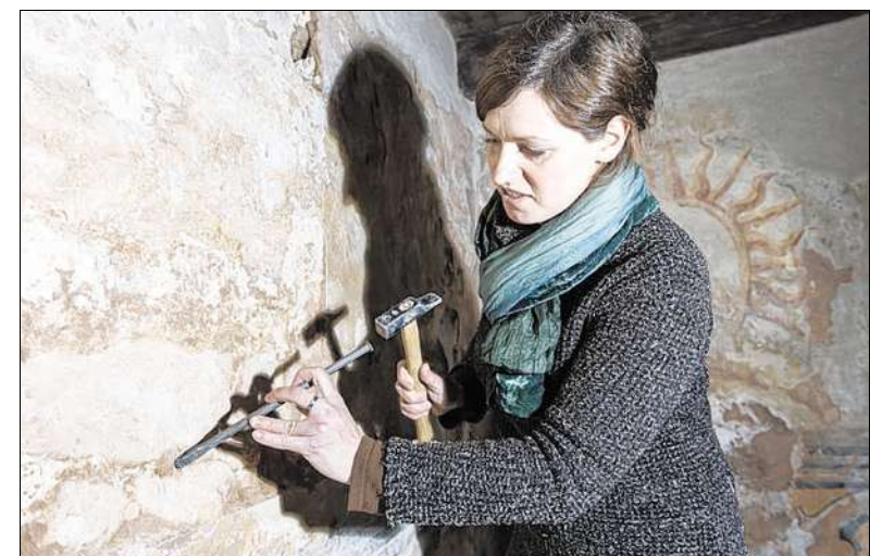
Die Südwestecke der Kapelle ist besonders geschädigt. Der salzhaltige rote Mörtel von 1972 wird hier soweit möglich abgeklopft.
