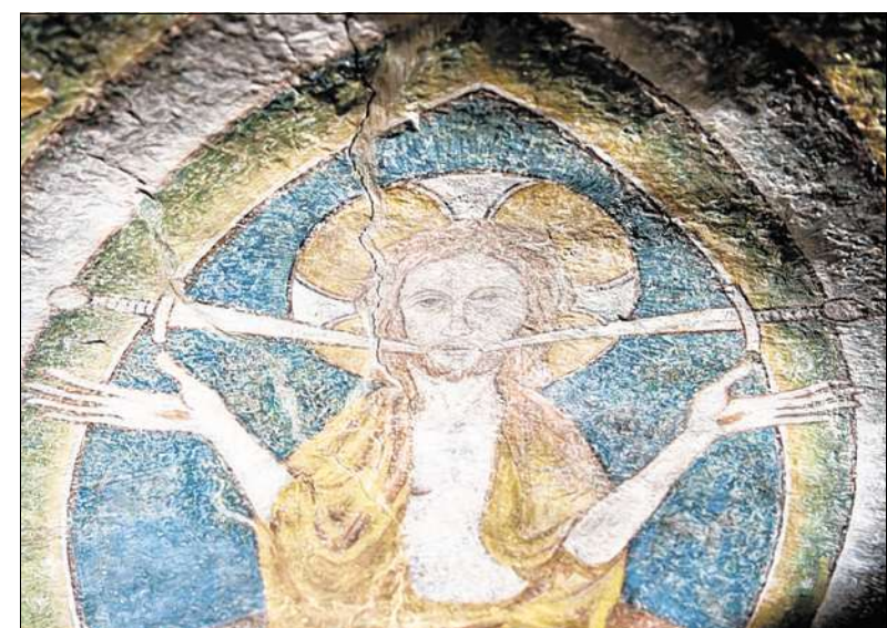
Ein langer Riss zieht sich durch die Darstellung Christi als Weltenrichter in der Apsis der Kapelle – Arbeit für die Restauratoren.
